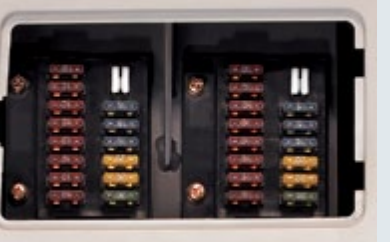
Cómoda ubicación de la caja de fusibles
